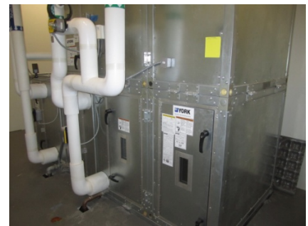
Figure G-9. DV-2 Fan Coil Unit
